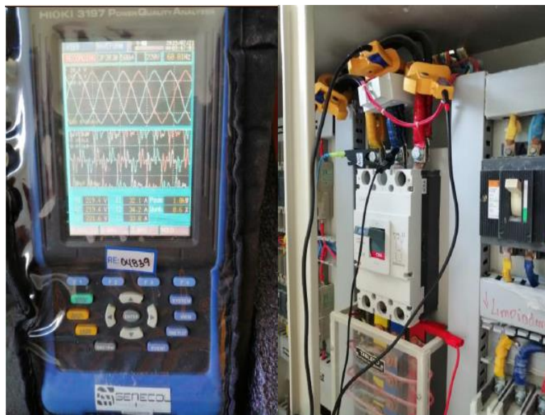
Figura 19. Registro fotográfico del analizador de redes instalado en Molinos Guanentá SAS.
