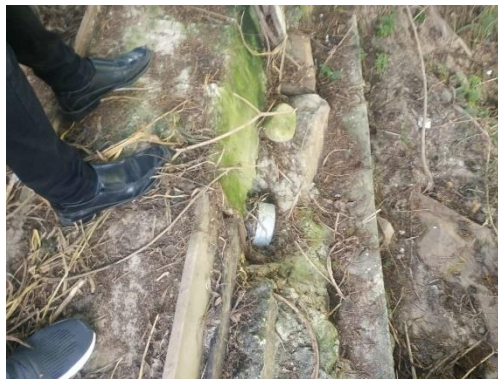
Ilustración 12. Tubería de desagüe del sedimento de la captación principal
