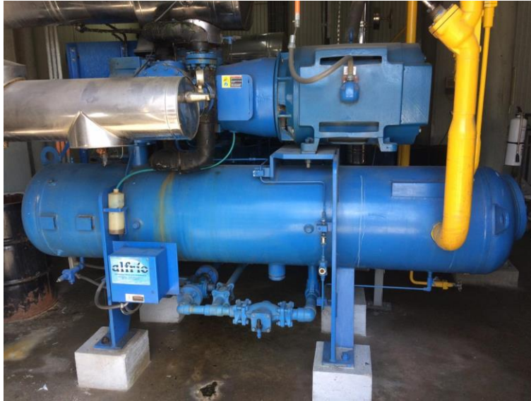
Figura 10: Compresor de alta instalado en el sistema de refrigeración de la planta Celfrío SAS.
