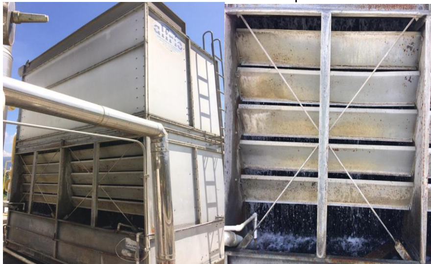
Figura 12: Sistema de condensación instalado en la planta Celfrío SAS.
