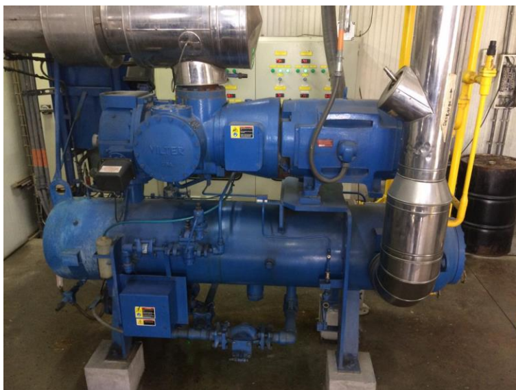
Figura 11: Compresor de baja instalado en el sistema de refrigeración de Celfrío SAS.
