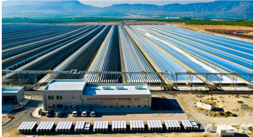
Ilustración 10. Planta termosolar Fresnel puerto errado 2, España
