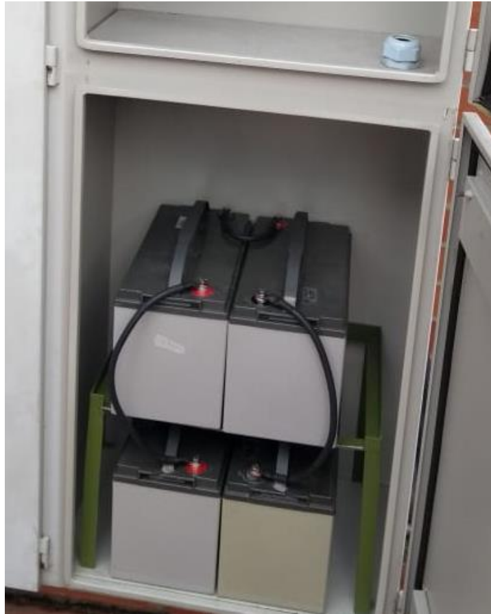
Figura 16. Banco de baterías del sistema.
