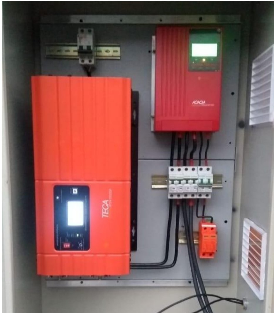
Figura 15. Equipos implementados con las protecciones necesarias para el sistema.
