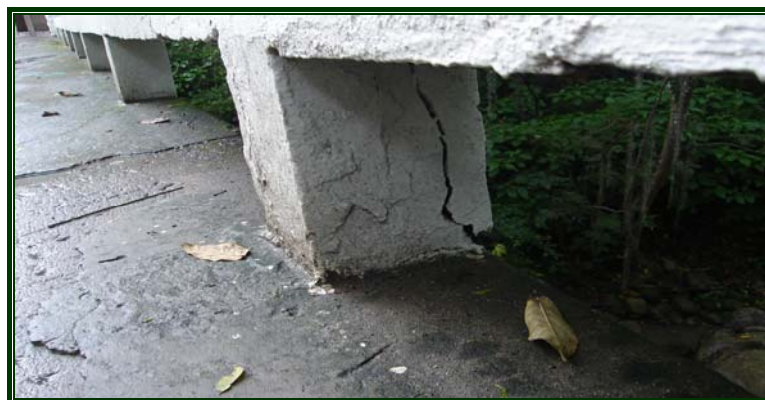
Figura 36. Deterioro de infraestructura Parque El Gallineral
