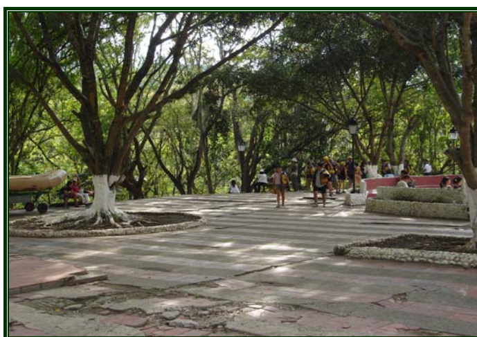
Figura 43. Deterioro del Malecón Turístico a causa de las actividades de canotaje
