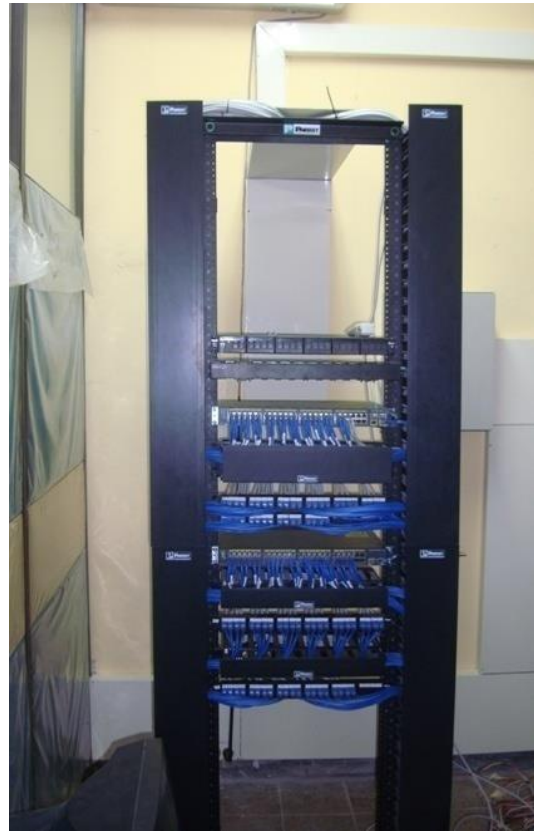
RACK SALA DE INFORMATICA
