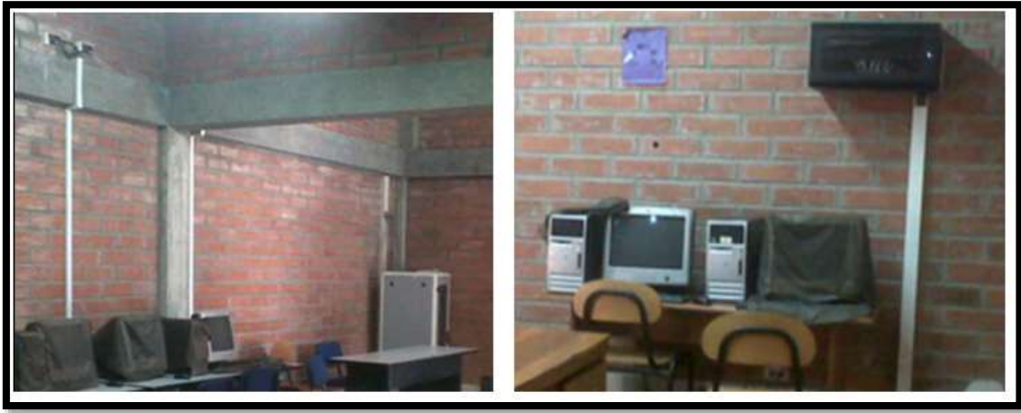
Figura 29. Canaletas de la red en Sala 1 y 2
