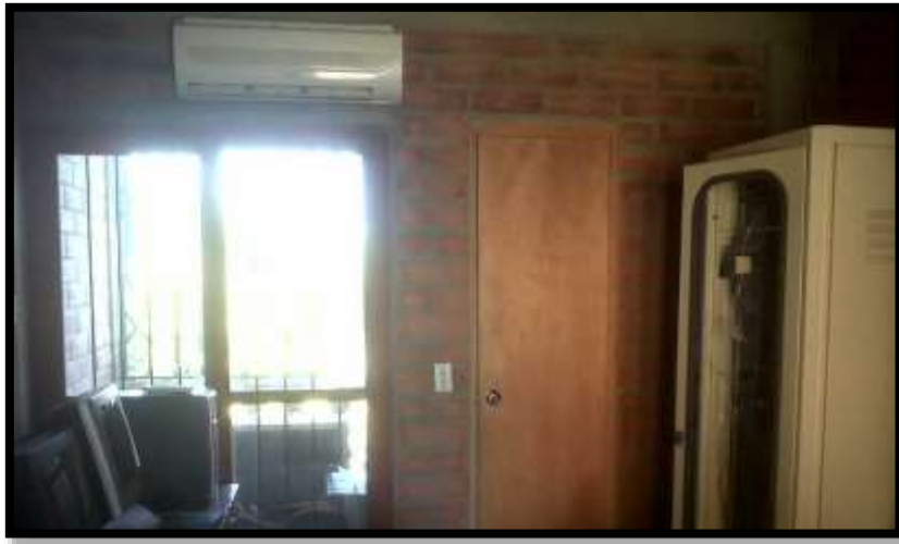
Figura 36. Datacenter del TECOC
