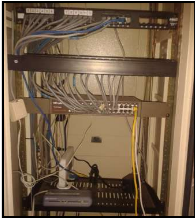
Figura 28. Gabinete de la red en el Datacenter
