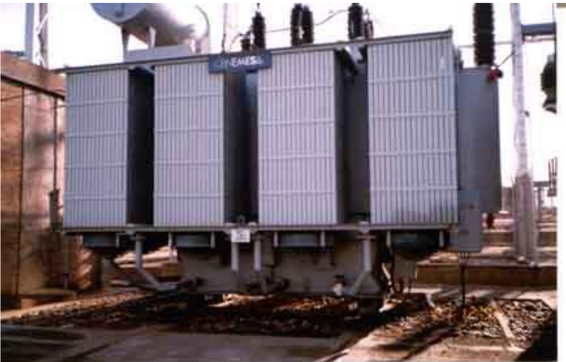
Figura N° 5 Transformador refrigerado por aceite
