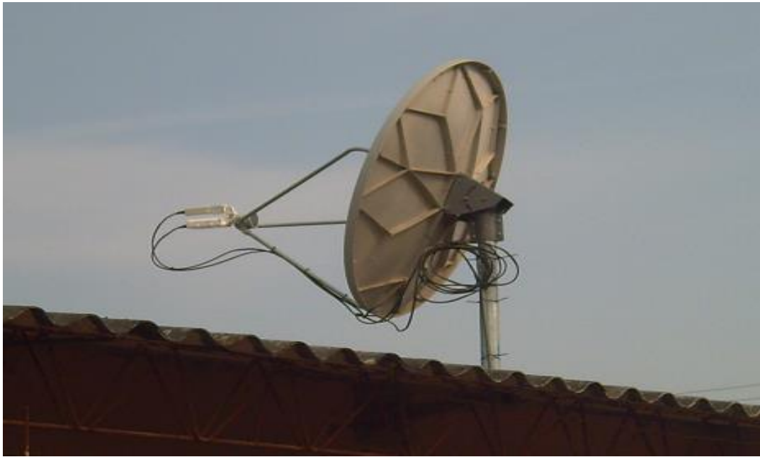
Anexo 8. Antena de Compartel Instalada en el colegio del corregimiento de Emaus.
