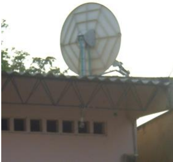
Anexo 5. Antena de Compartel Instalada en el colegio del corregimiento de Florencia.
