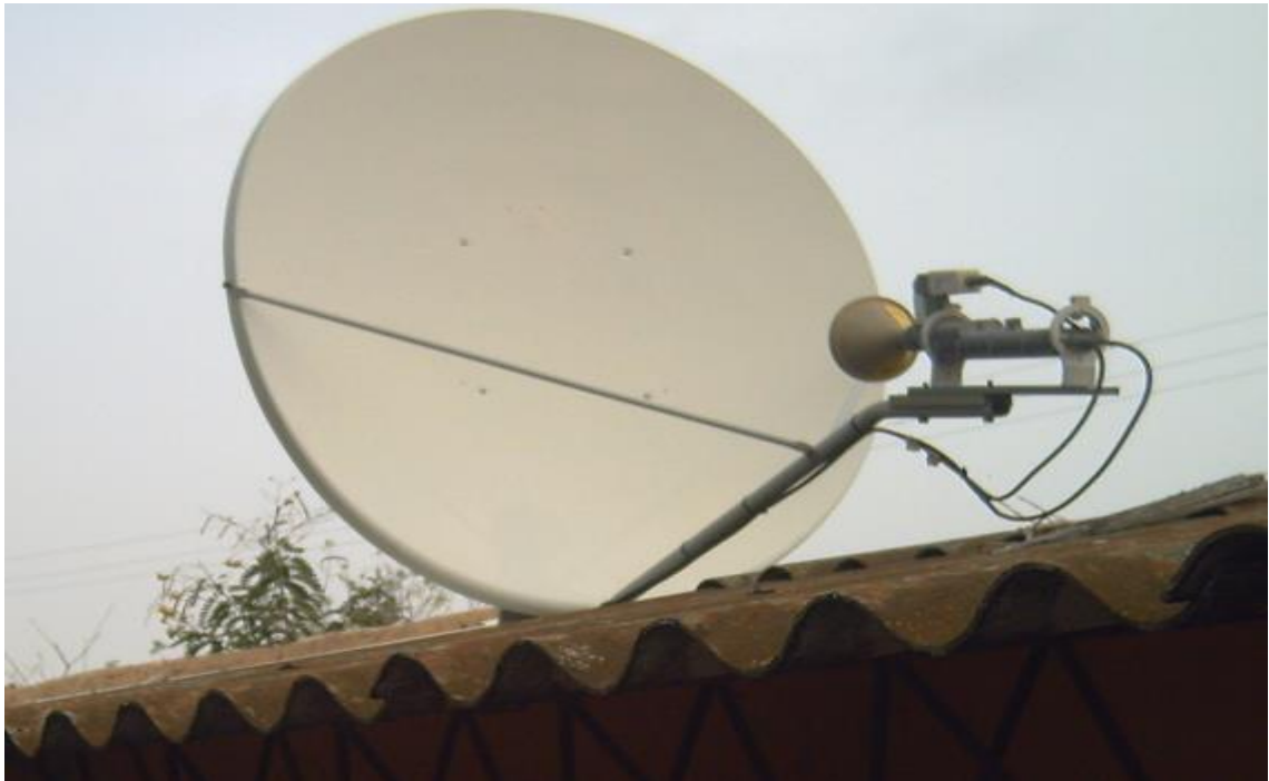
Anexo 4. Antena de Compartel Instalada en el colegio del corregimiento del Cuatro.
