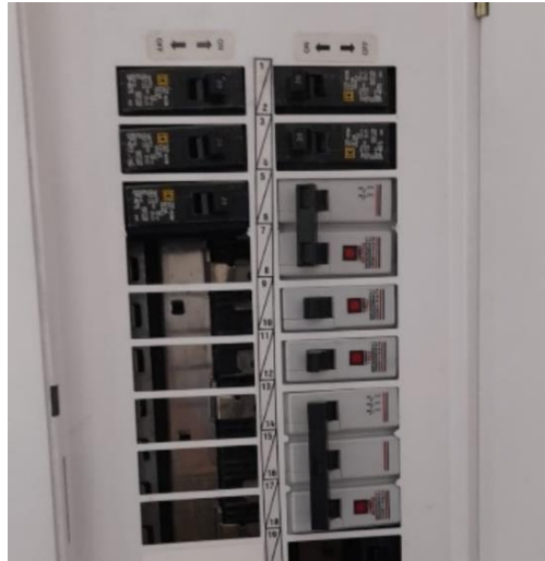
Figura 11. Tablero de Protecciones
