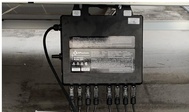
Figura 19. Conexiones en el Microinversor a los Paneles Solares
