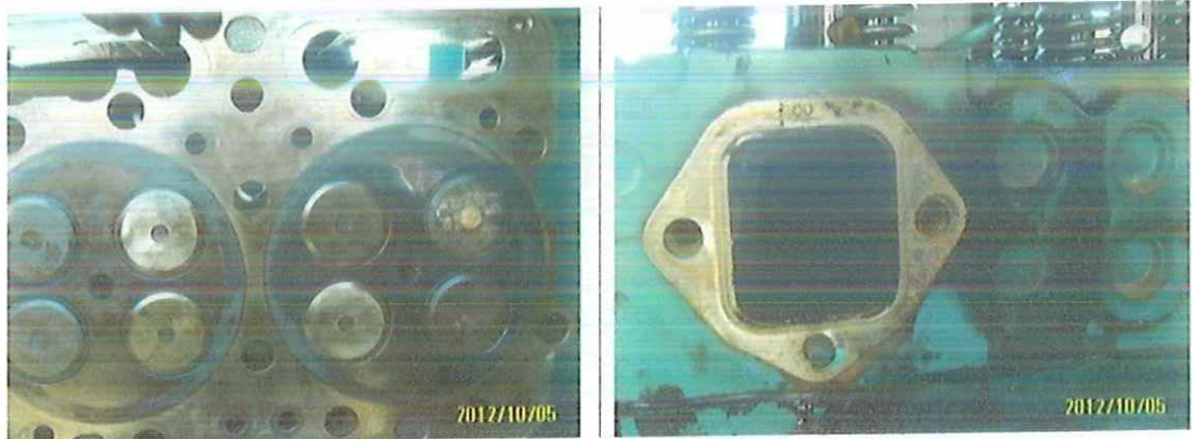
Válvulas de admisión CYL 6 con presencia de Tierra Gatería de múltiple de escape con alto nivel de carbonamiento
