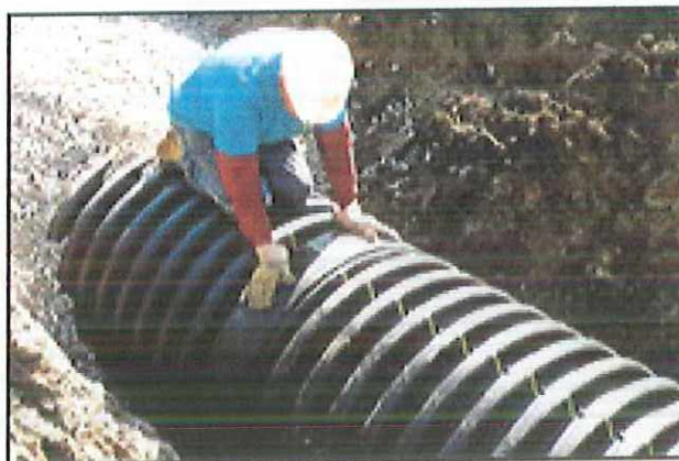
Fotografía 2. Tubería ADS N-12
