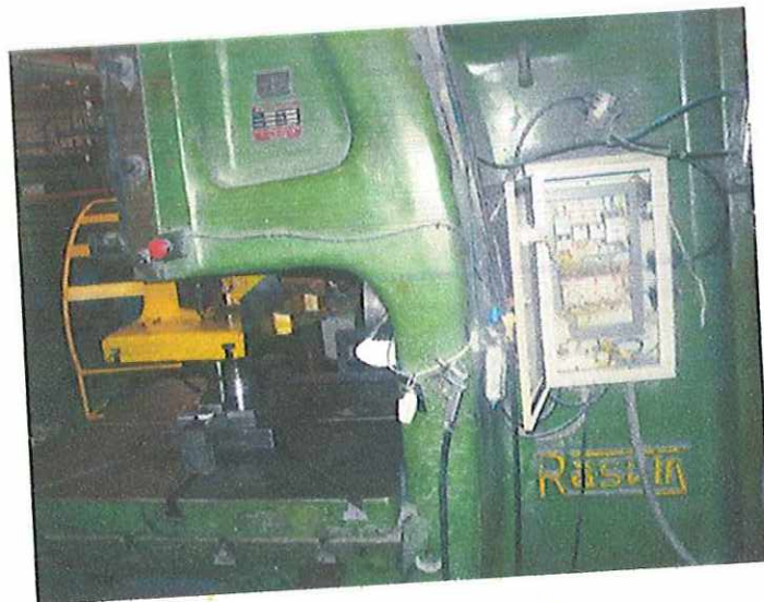
Troqueladora con sensor Inductivo y contactores
