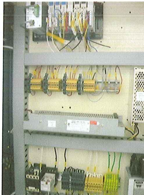
Figura 18 Panel de Automatización
