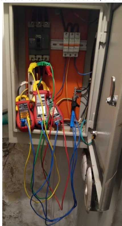
Figura 5. Conexión de medición de ascensores
