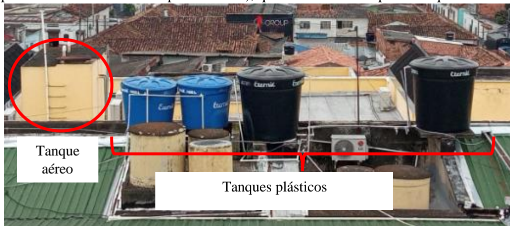
Figura 6. Tanques plásticos + Tanque aéreo
