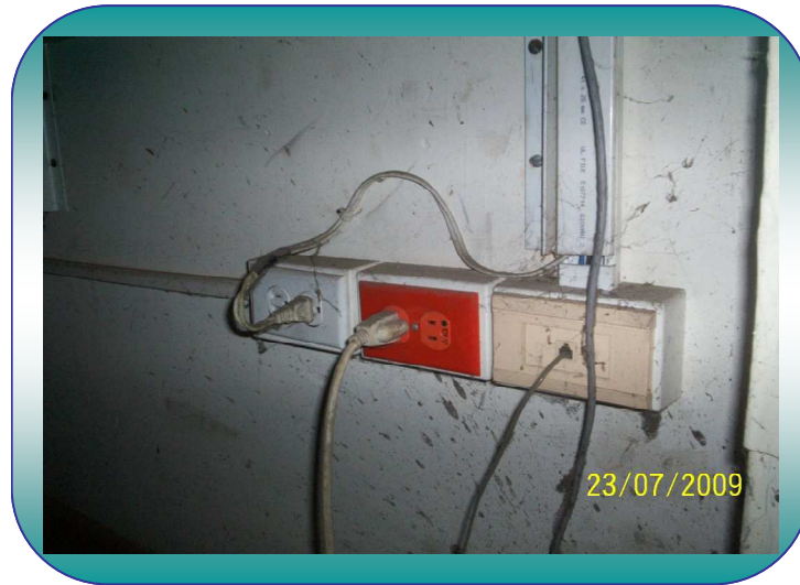
FOTOGRAFÍA de las instalaciones eléctricas. Bucaramanga. Julio de 2009
