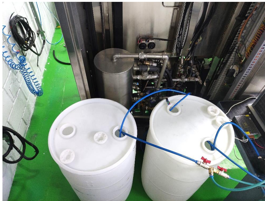
Figura 20. Tanques de agua del sistema, de izquierda a derecha el tanque reservorio 2 y el tanque reservorio 1.
