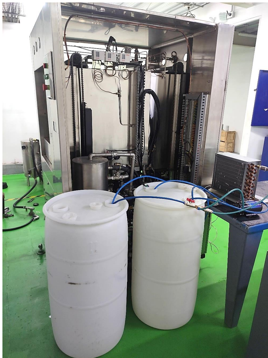
Figura 17. Sistema de recirculación instalado en el esterilizador modelo STE-400
