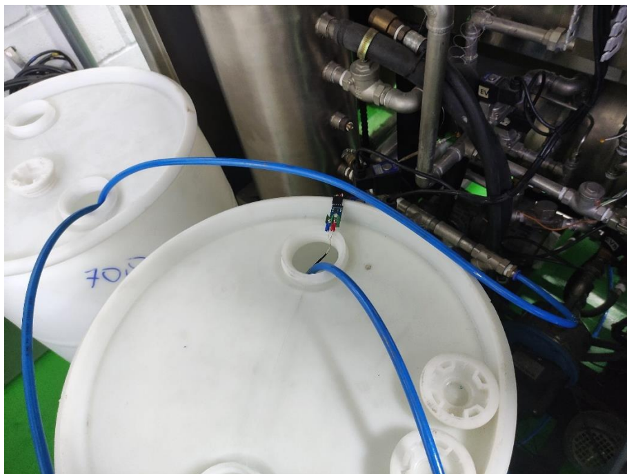
Figura 21. Conexión de entrada de agua al equipo y vista del módulo MAX6675
