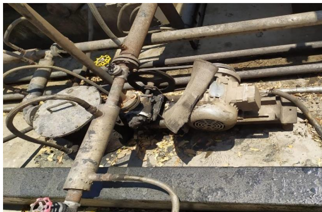
Figura 14. Bomba de asfalto
