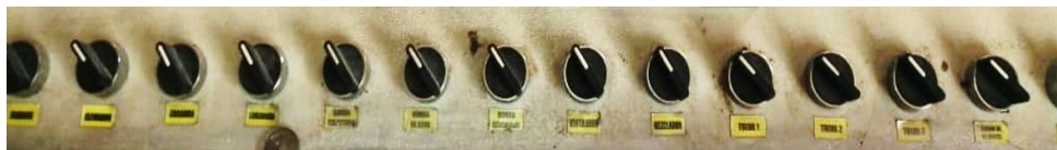
Figura 27. Botonera para el funcionamiento de la planta de asfalto.
