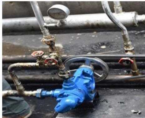
Figura 10. Bomba de combustible.
