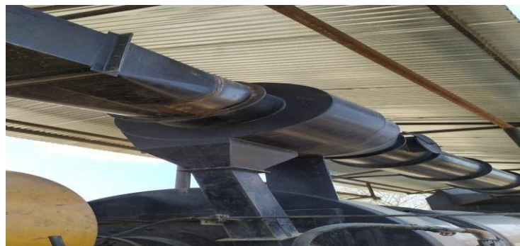
Figura 12. Tubería del colector de finos.
