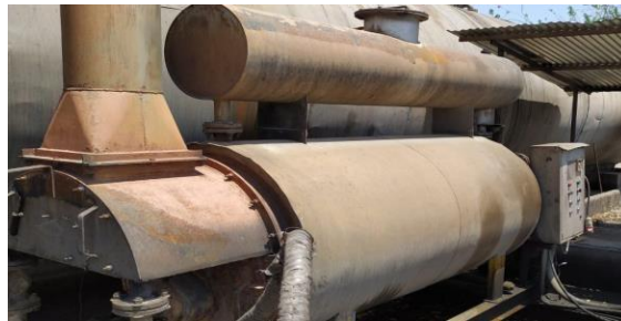
Figura 16. Caldera de la planta de Ruma Ingeniería S.A.S.
