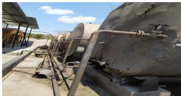
Figura 17. Tubería Encendido de Caldera y Calentamiento de Asfalto
