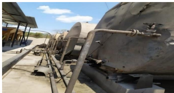
Figura 20. Bomba de combustible.
