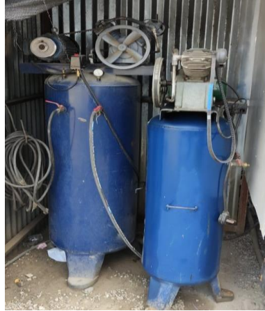
Figura 25. Compresor para la apertura de la compuerta de la tolva de bachadas.
