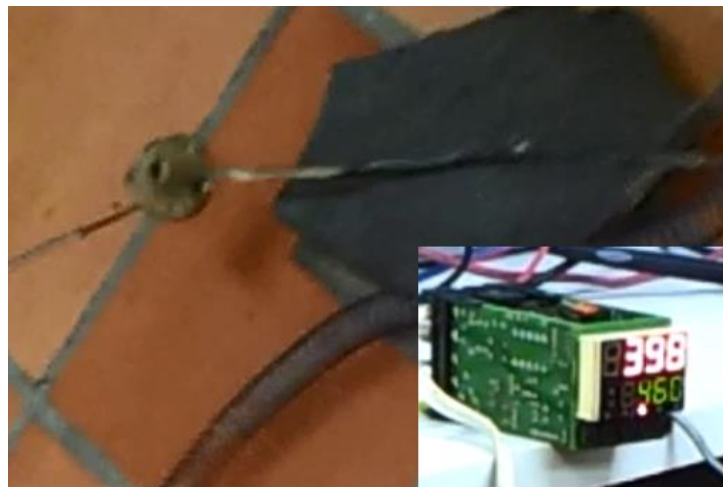
Ilustración 153 Medición con la nueva termocupla tipo K
