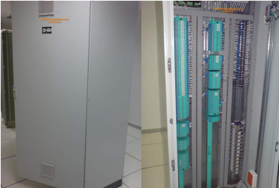
Exterior e interior del Gabinete Marshalling para entradas y salidas
