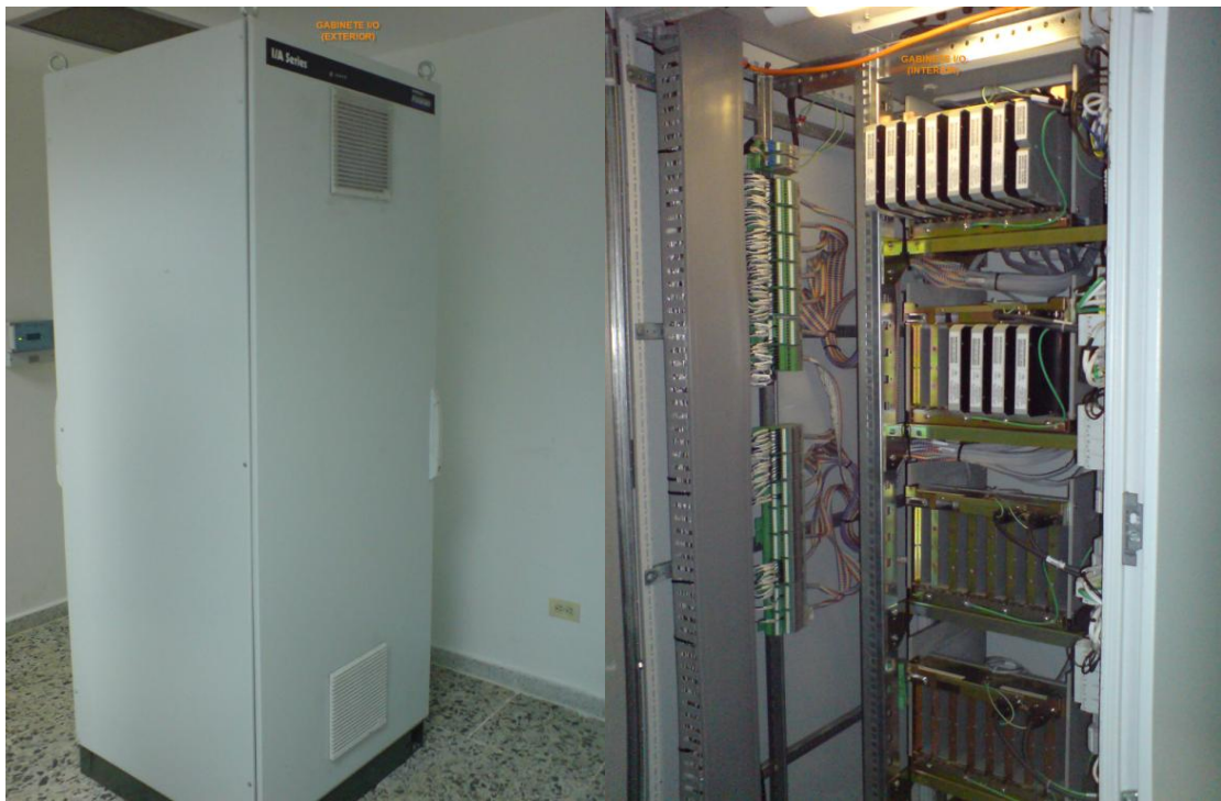
Exterior e interior del Gabinete de tarjetas I/A Foxboro
