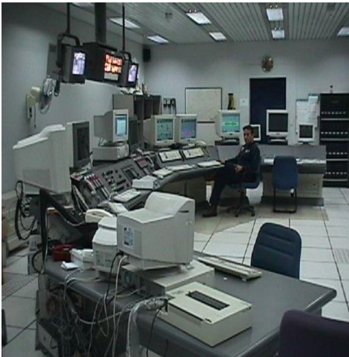
Figura 24. Cuarto de control Planta de Parafinas, del autor
