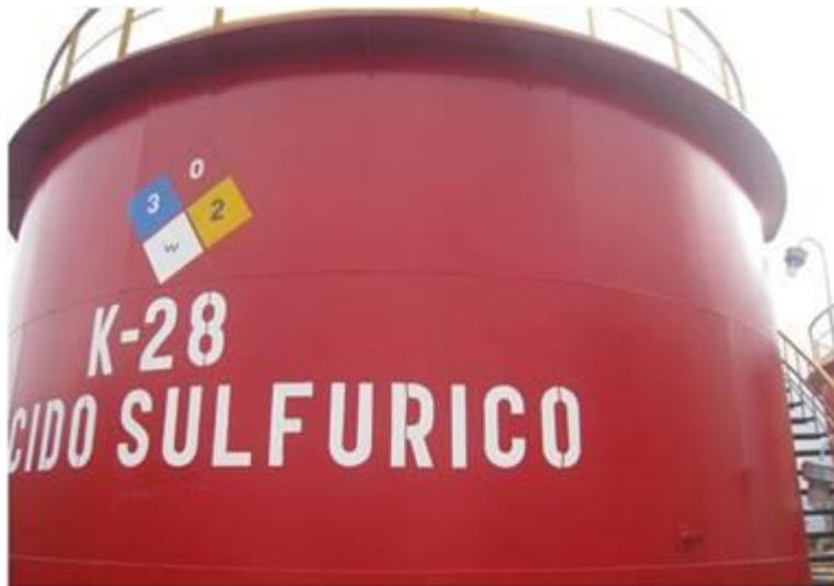
Tanque K-28, Casa Bombas 5
