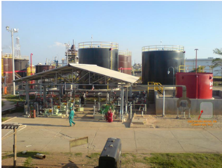
Zona de bombas Proyecto Tratamiento de sodas gastadas y caldos microbianos (Planta de Tratamiento de Aguas Residuales - PTAR)
