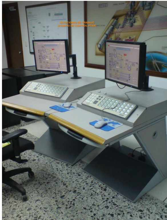
Estaciones de trabajo (paneles) en el cuarto de control de PTAR
