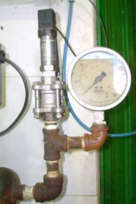
Fotografía 2. Instrumentación de Presión.
