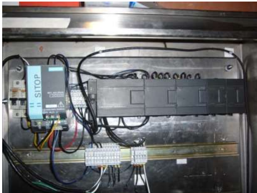
Fotografía 1. Tablero de Control.
