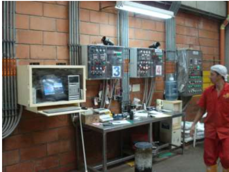
Fotografía 4. Ubicación del SCADA en la planta.
