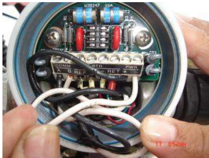
Foto 3. Conexión terminales sensor RTD
