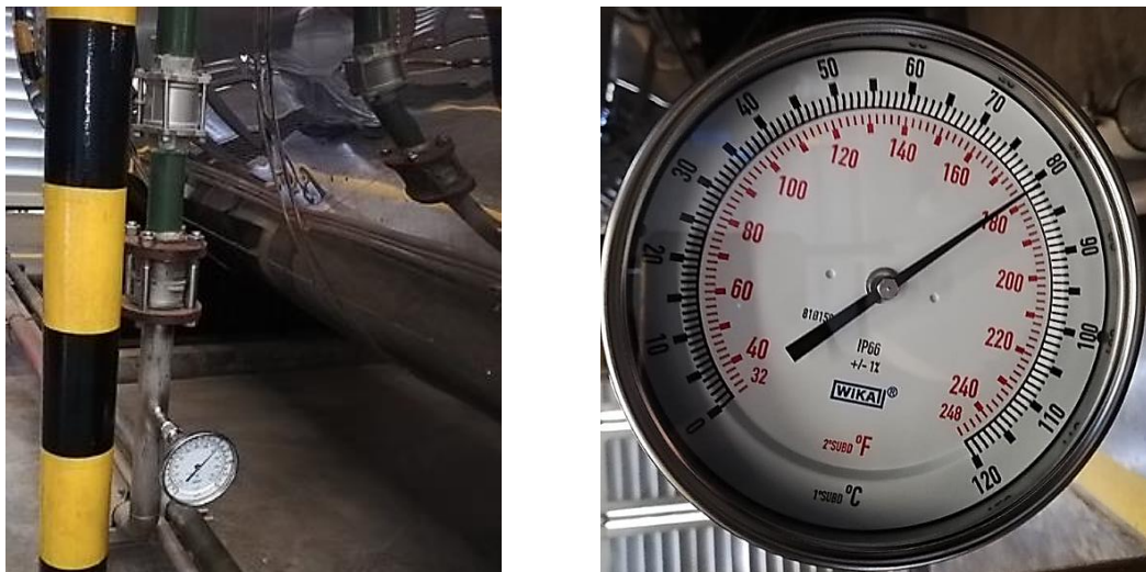
Ilustración 30. Termopozo para el agua de alimentación de las Calderas
