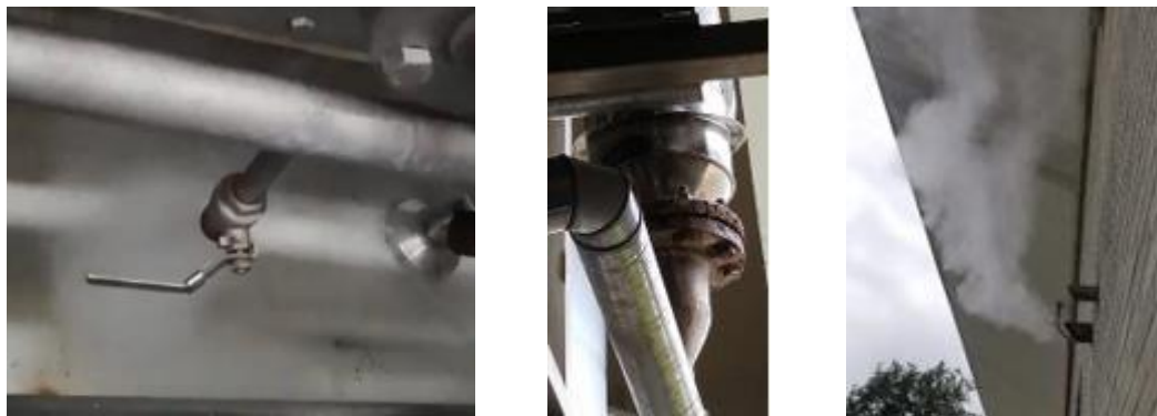
Ilustración 27. Fugas de vapor en el sistema de Distribución (Fuente: Gaseosas Hipinto S.A.S).
