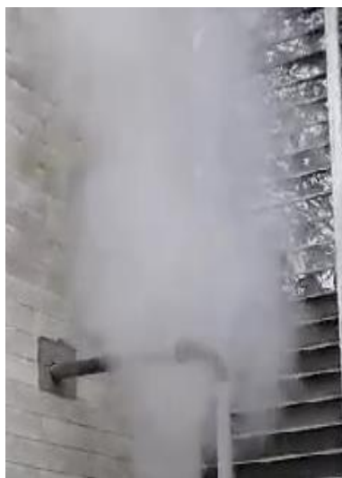
Ilustración 29. Vapor venteado a la atmósfera a causa de la trampa en fallo
