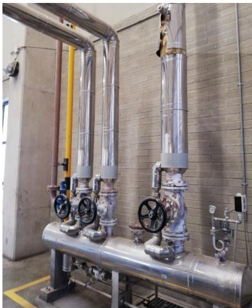
Ilustración 16. Distribuidor de vapor en la planta de Gaseosas Hipinto S.A.S.
