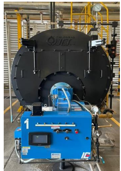
Ilustración 4. Calderas pirotubulares de la planta de Gaseosas Hipinto S.A.S.
