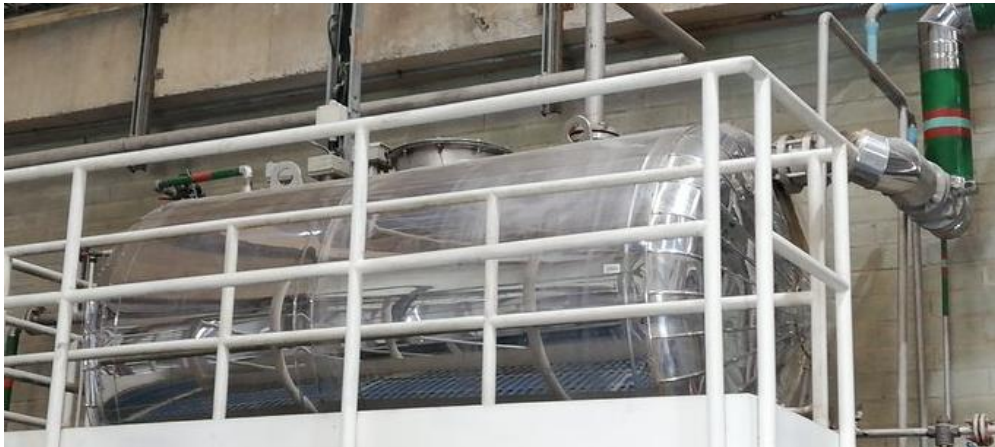
Ilustración 19. Tanque de diario de la planta de Gaseosas Hipinto S.A.S.
