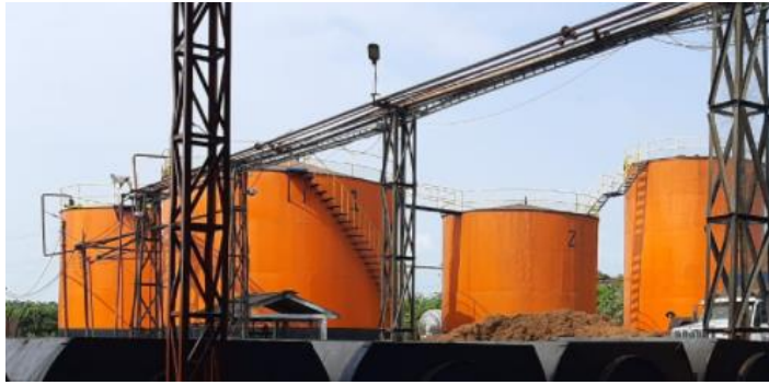
Figura 15. Tanques de almacenamiento
