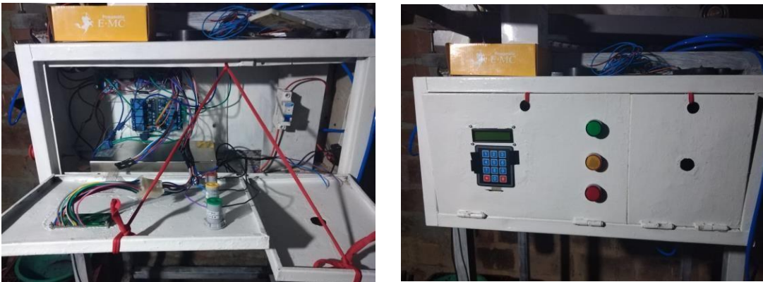
Ilustración 111. Conexiones caja de control.
