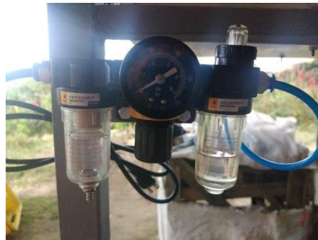
Ilustración 91. Unidad de mantenimiento.
