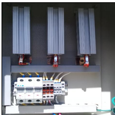
Figura 19. Resistencias de Compensación instaladas en un punto de frontera para CT's.
