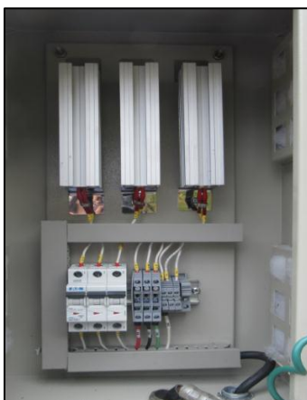
Figura 20: Resistencias de Compensación instaladas en un punto de frontera para PT's
