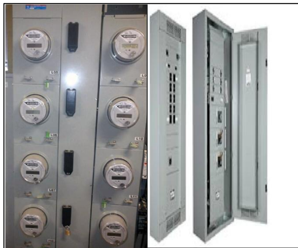
Figura 17. Panel o tablero para medidores de energía eléctrica.
