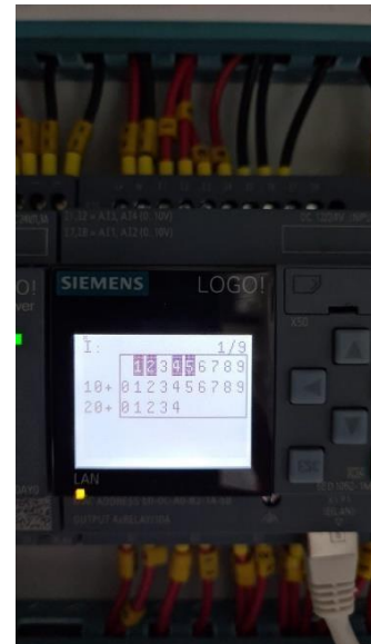
Figura 46. Verificación entrada digital 7 en el PLC que corresponde al LED de la máquina SANMAK FUENTE: Autor.
