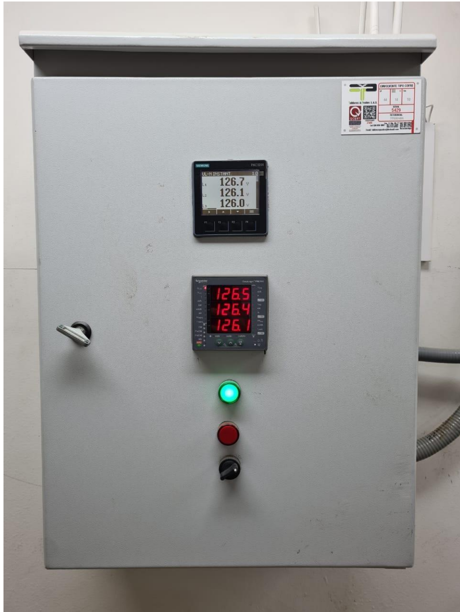
Figura 27. Panel Principal del tablero con switch de encendido. FUENTE: Autor.
