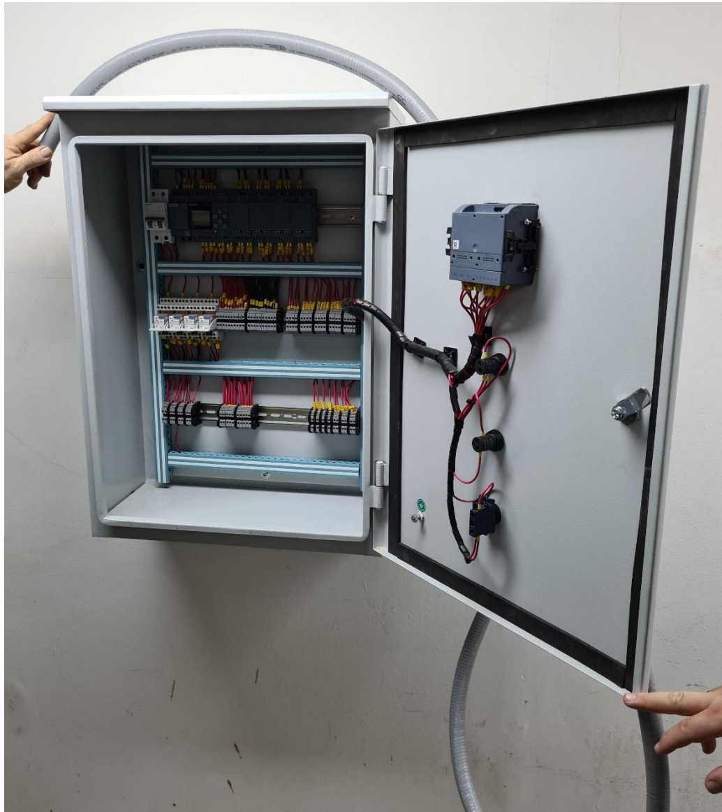
Figura 24. Tablero Montado con el PLC y el analizador SIEMENS previo instalación de conexiones. FUENTE: Autor.
