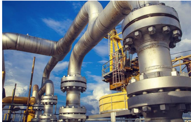
Ilustración 22: Sistema de tubería unido con bridas
