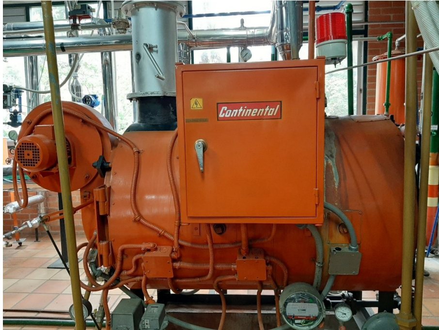
Figura 1.3: Caldera planta piloto
