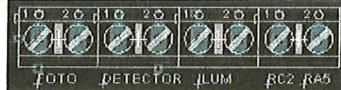
Figura 33 Borneras instaladas en el Circuito
