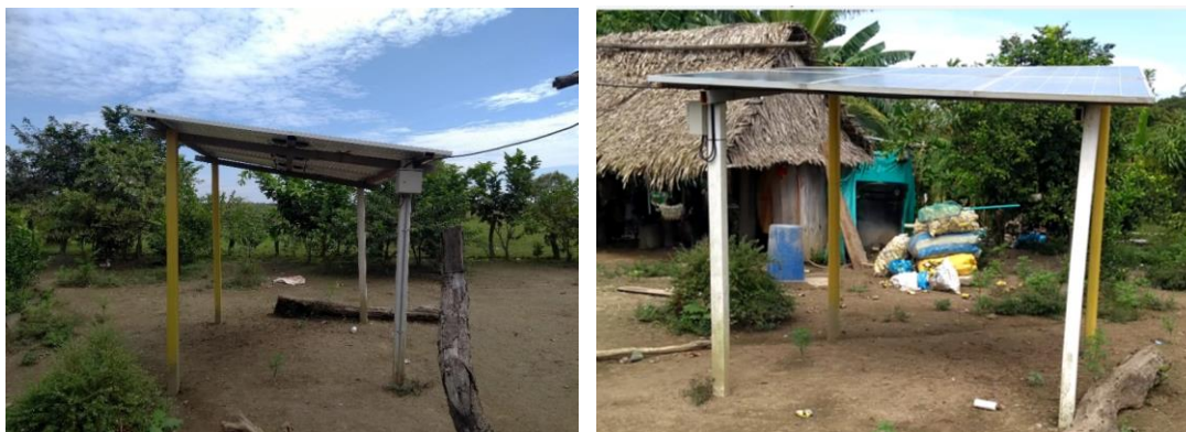
Figura 49. Soporte de los módulos fotovoltaicos ubicados en la vereda Las Flores/Santa Bárbara.
