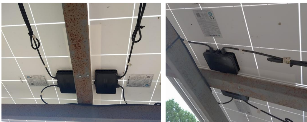
Figura 48. Estructura del soporte de los sistemas fotovoltaicos (vereda Las Flores/Santa Bárbara).
