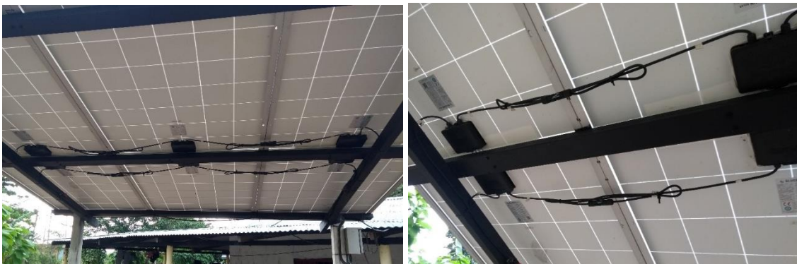
Figura 56. Conexiones del arreglo fotovoltaico.
