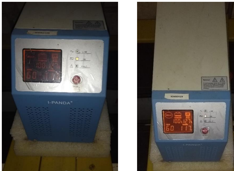
Figura 53. Inversor (I-PANDA) dispuesto en la finca San Pablo de la Vereda Las Flores/Santa Bárbara.
