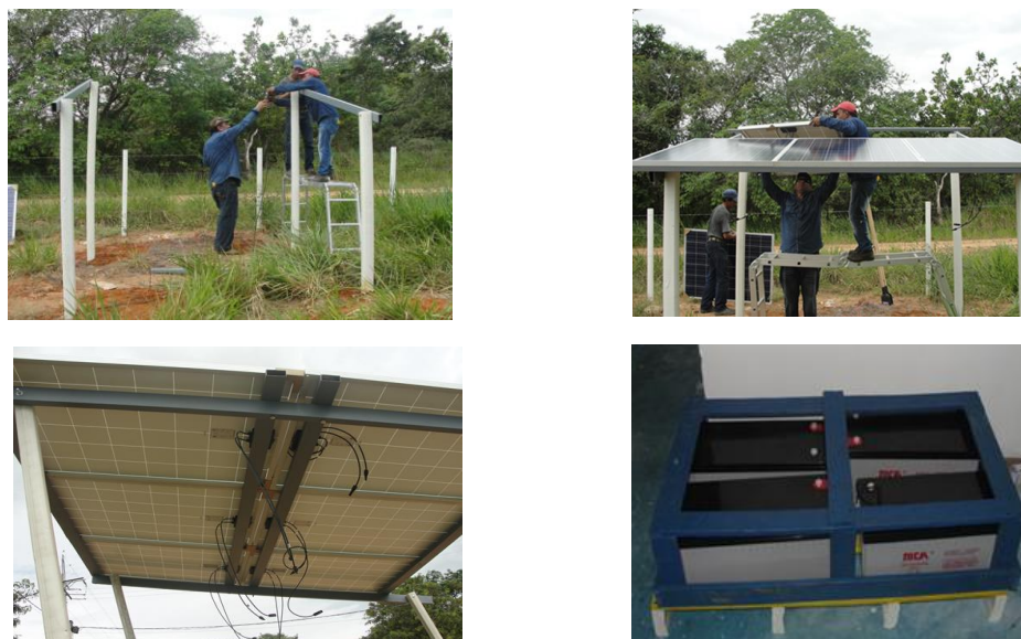
Figura 18. Sistemas fotovoltaicos instalados.
