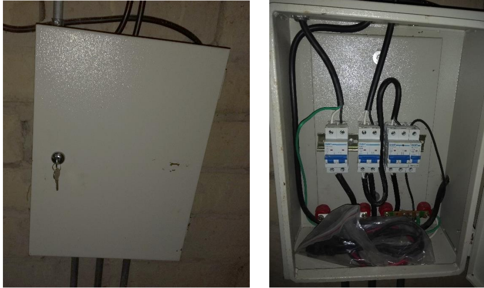
Figura 57. Caja de distribución de distribución eléctrica.
