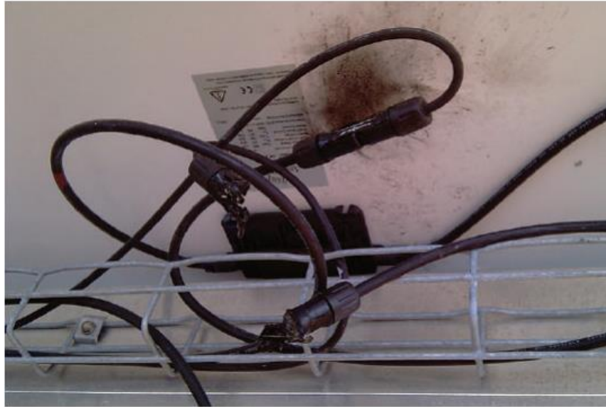
Figura 4. Conectores quemados por mala conexión
