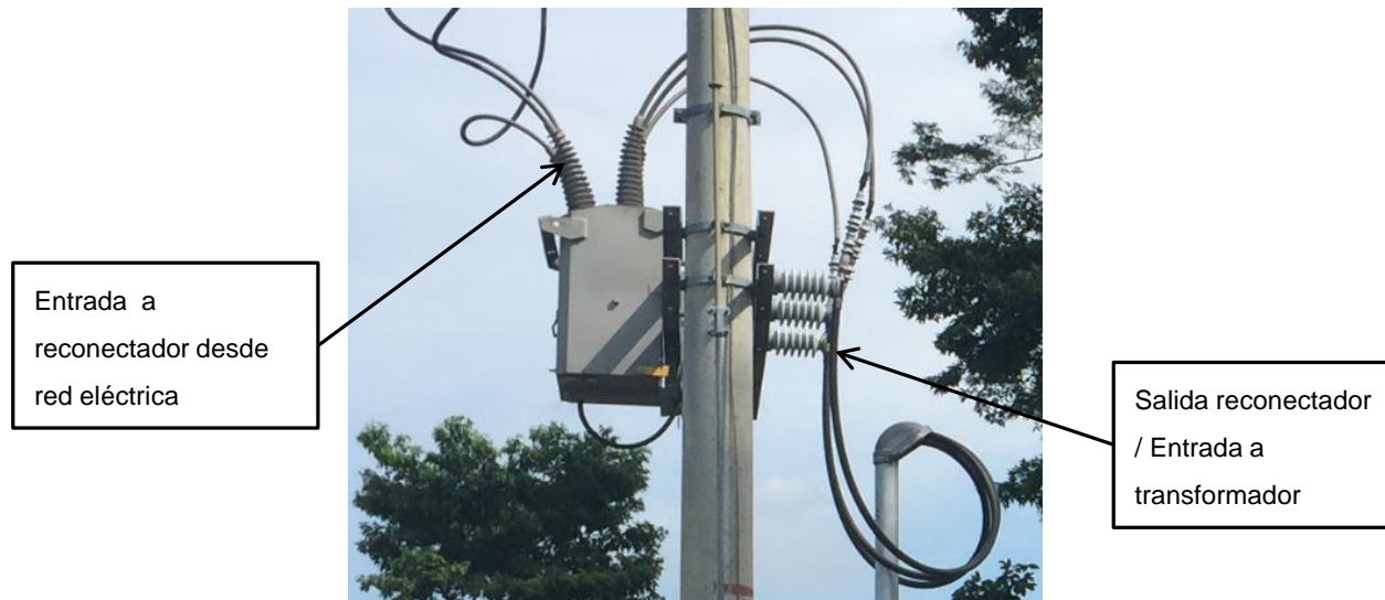
Figura 4. Reconectador S/E 214. [Autor].
