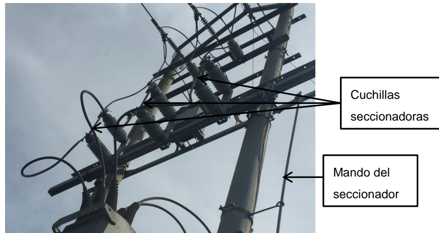
Figura 5. Seccionador eléctrico. [Autor].
