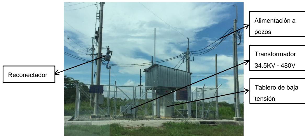
Figura 3. S/E eléctrica 412. 34,5KV / 480-277V / 500KVA. [Autor].
