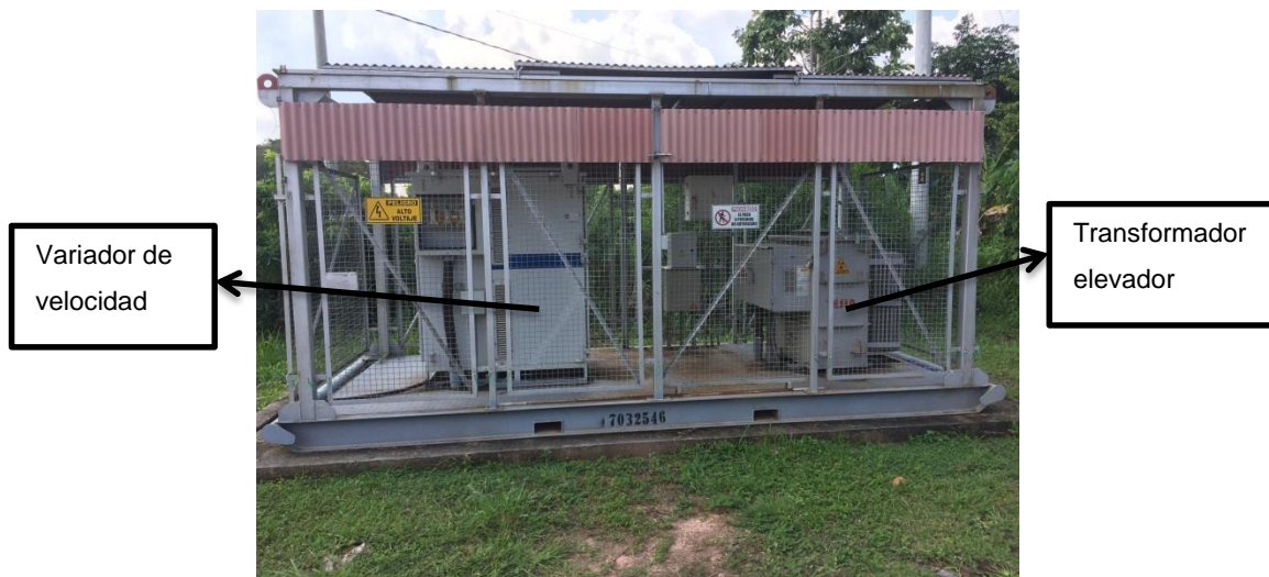
Figura 13. Caseta de control para bombeo electrosumergible. [Autor].
