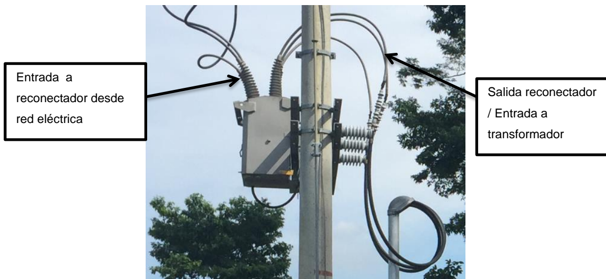
Figura 5. Reconectador S/E 214. [Autor].
