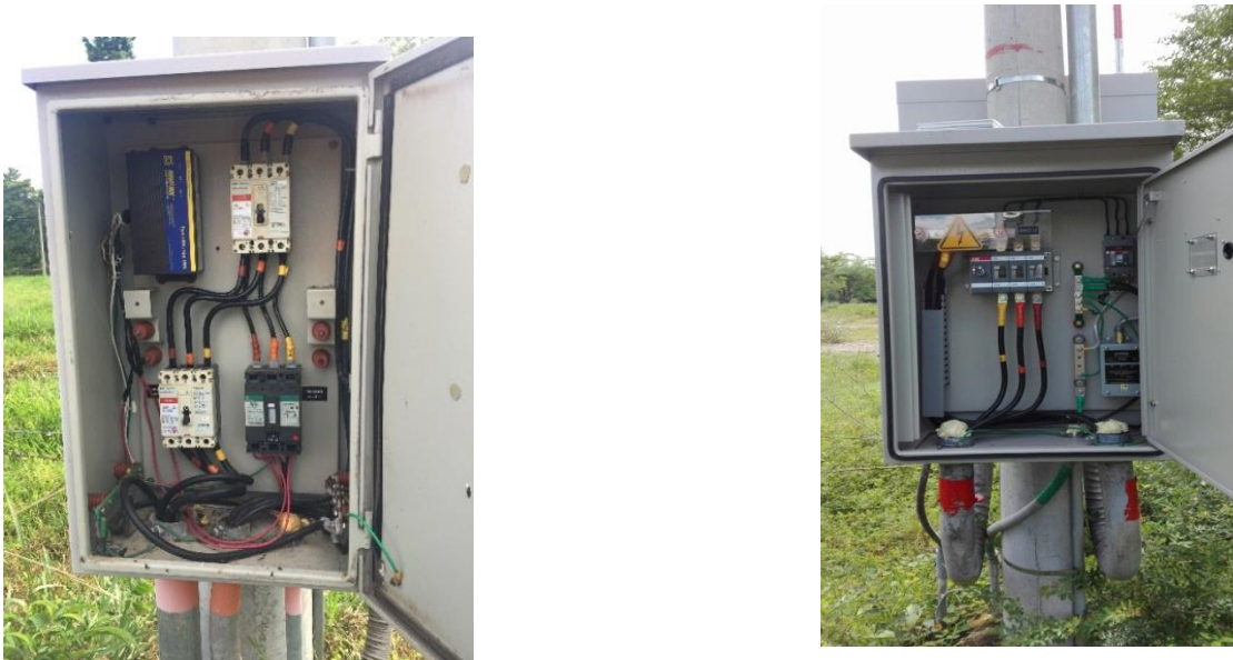
Figura 7. Caja de paso y caja de corte. [Autor].
