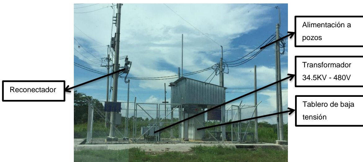
Figura 4. S/E eléctrica 412. 34,5KV / 480-277V / 500KVA. [Autor].
