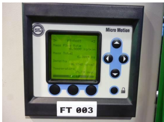
Imagen 6. Controlador del flujometro
