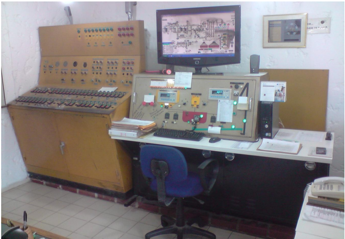
Figura 1. Sala de control
