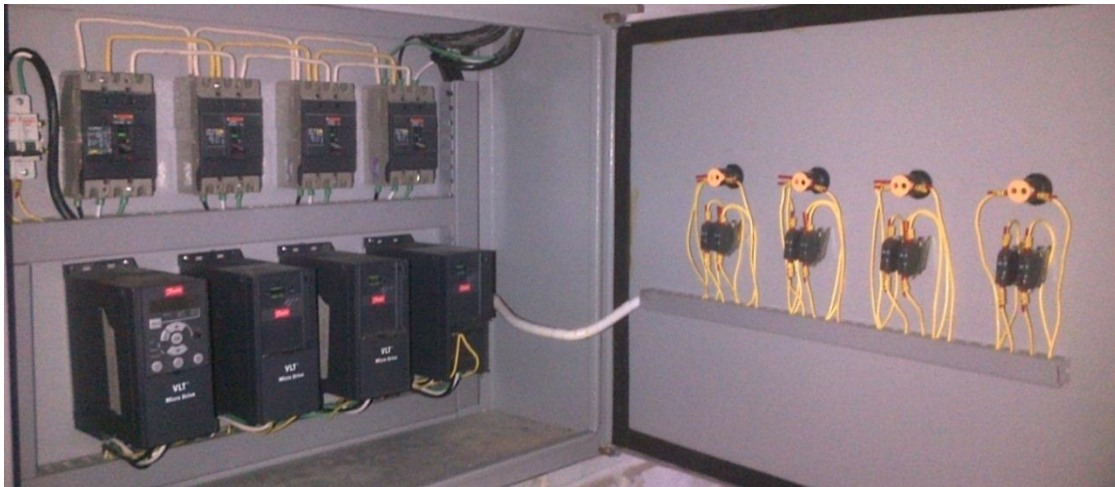
Figura 21. Gabinete proceso de dosificación
