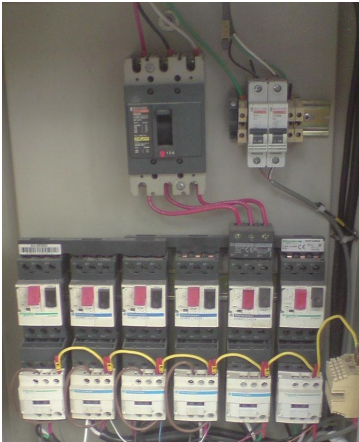
Figura 23. Gabinete de arranques distribuidores
