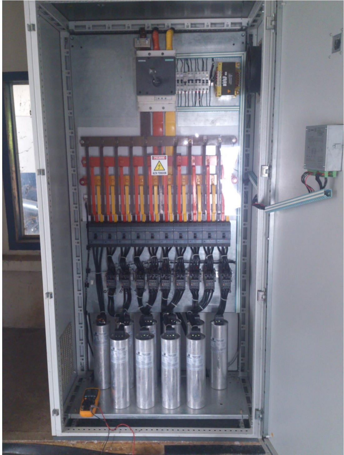
Ilustración 18. Banco de condensadores
