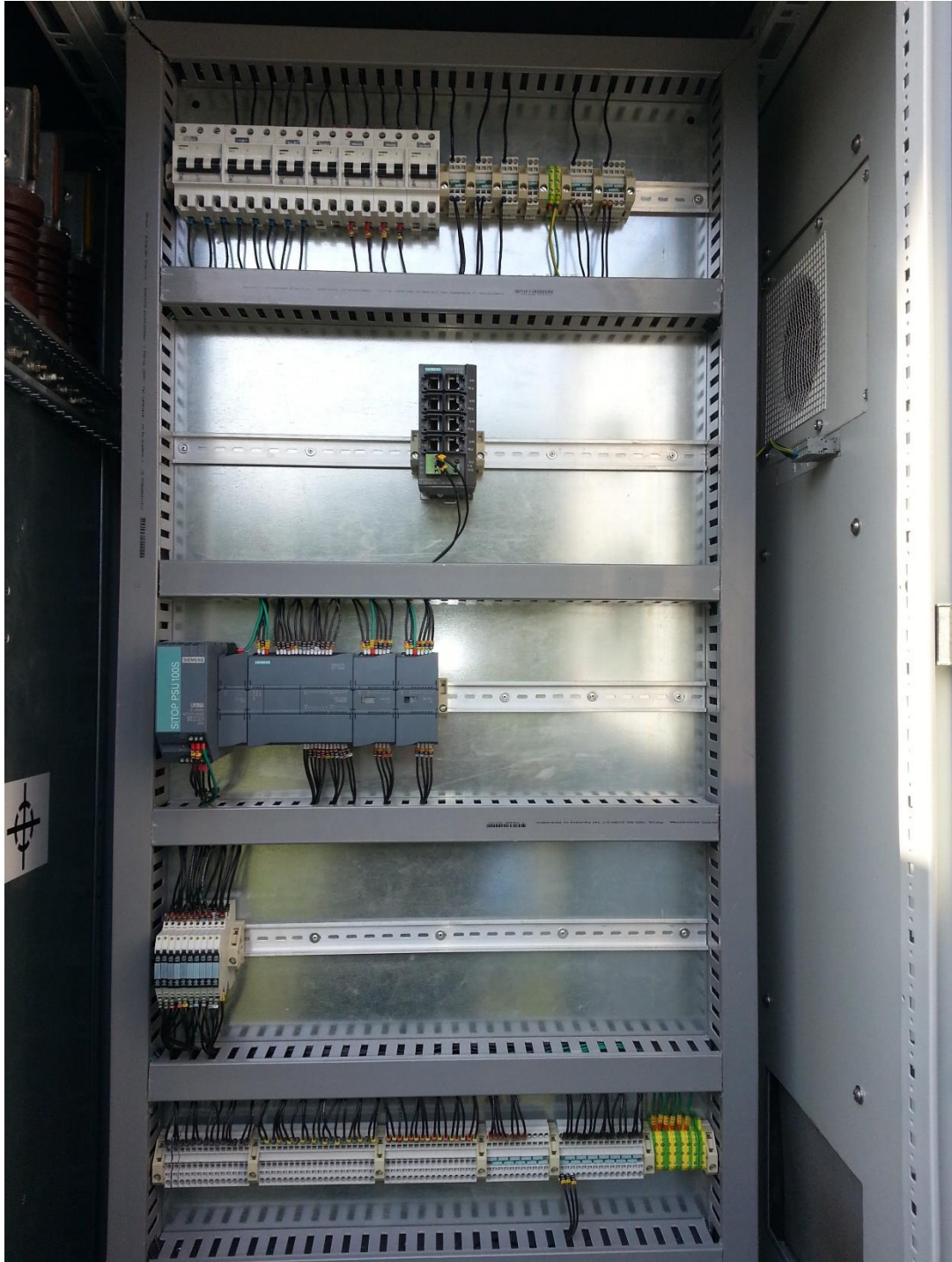
Ilustración 17. Tablero de control PLC
