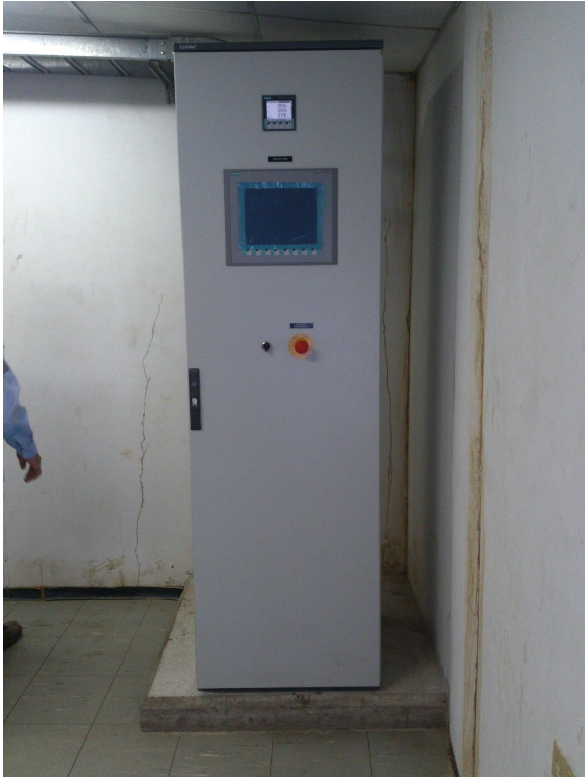
Ilustración 22. Tablero de control
