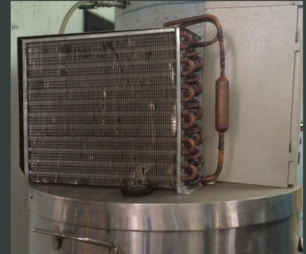
Radiador del chiller.
