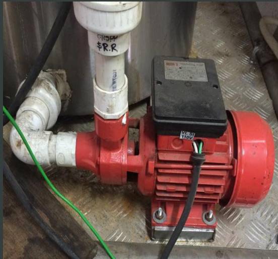
Bomba de suministro y retorno del chiller
