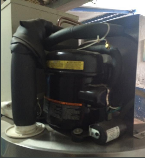
Motor - compresor del Chiller
