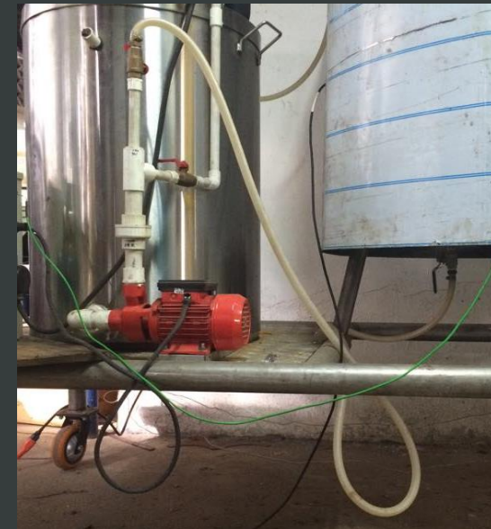
Manguera conectada entre el chiller y el tanque fermentador para que transporte el agua fría al tanque desde el chiller.
