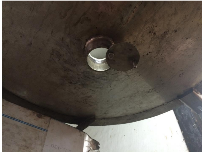
Figura 7-8. Compuerta del tanque con orificio central.
