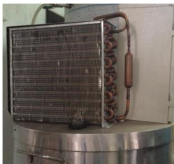
Figura 7-6. Radiador del chiller.
