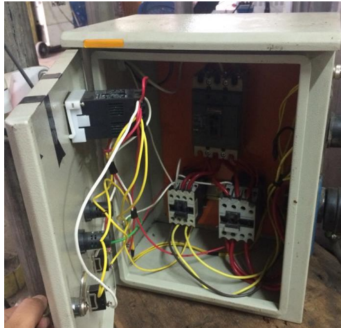
Figura 7-20. Parte interna de la caja de control de temperatura.
