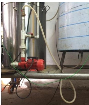
Figura 7-5. Manguera conectada entre el chiller y el tanque fermentador para que transporte el agua fría al tanque desde el chiller.
