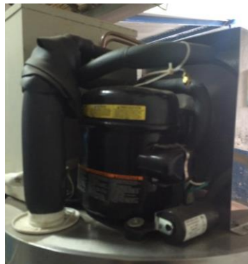
Figura 7-2. Motor - compresor del Chiller
