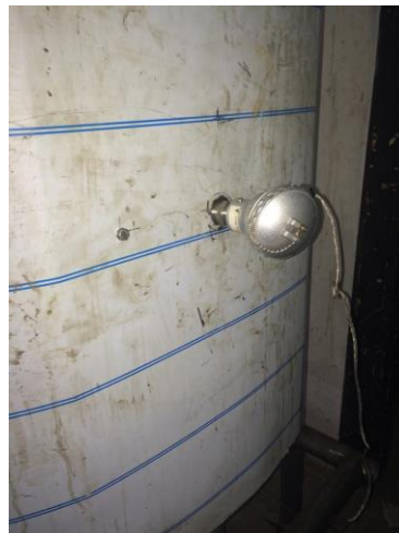
Figura 7-15. Ubicación de la segunda PT100 en la parte inferior del tanque fermentador.
