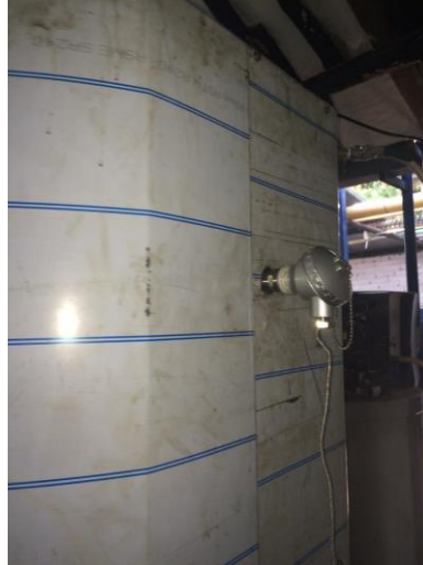
Figura 7-14. Ubicación de la PT100 en el tanque fermentador en la parte superior.
