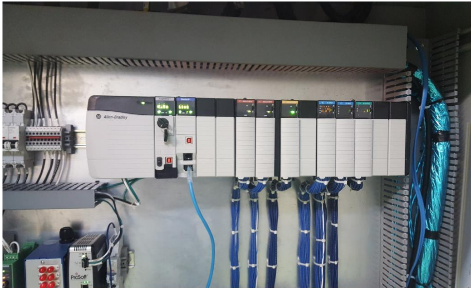
Ilustración 4 Controlador Allen Bradley 1756-L72
