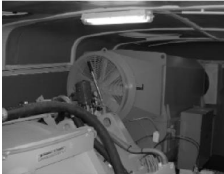
Ilustración 8. Generador eléctrico en el interior de la carcasa o góndola de un aerogenerador de potencia. [6]
