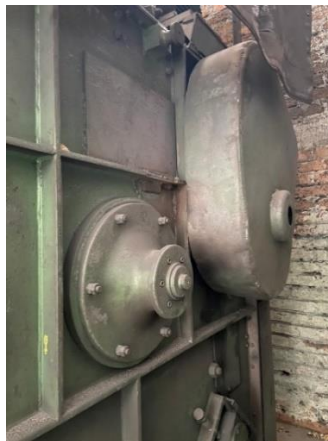
Ilustración 5 Sistema de transmisión granalladora. [Autor]
