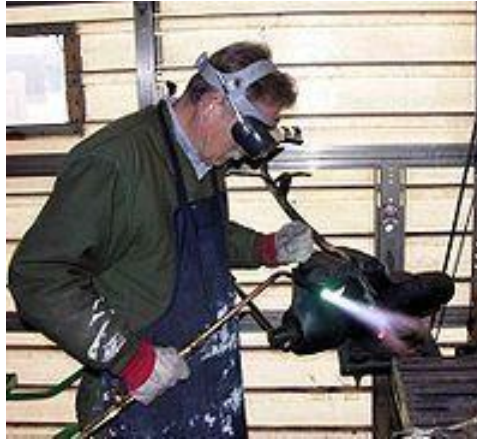
Figura 24. Soldadura a gas de una armadura de acero usando el proceso de oxiacetileno.
