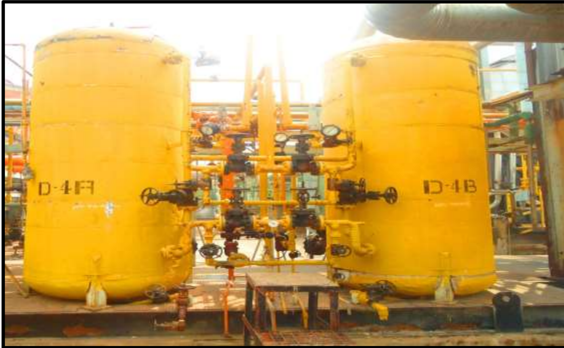
Figura 2. Tambores de carbón activado D-4A/B.
