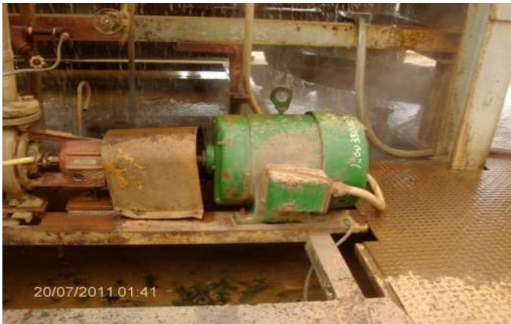
Imagen 12. Bombas de MEA.
