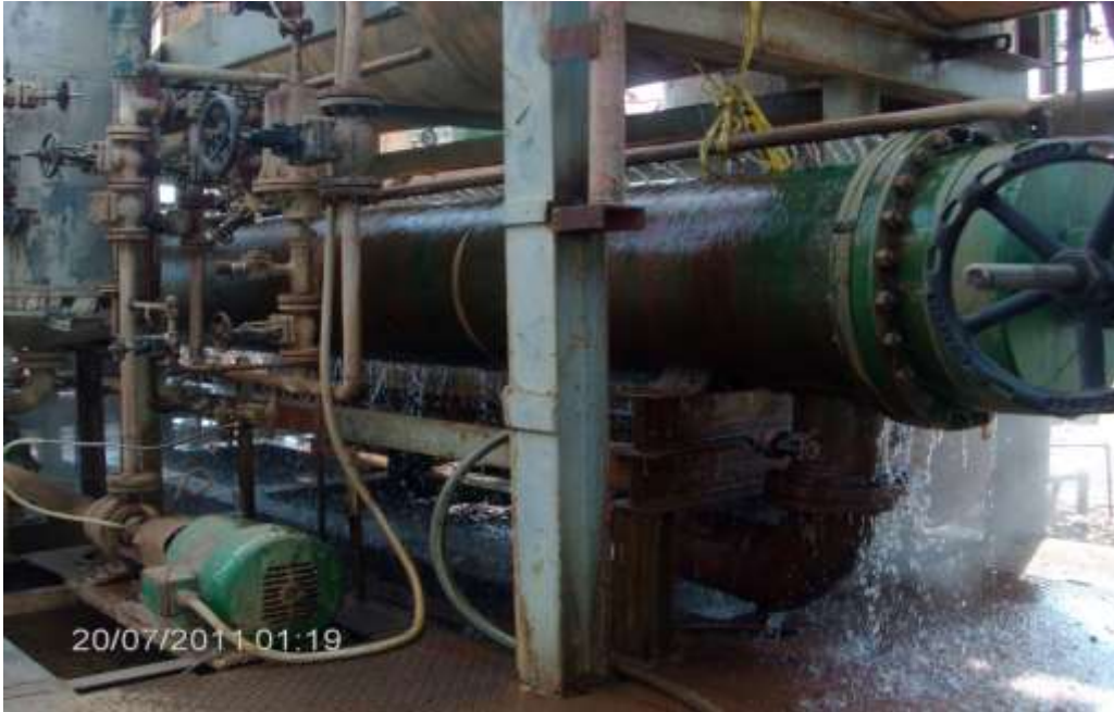
Imagen 10. Intercambiador de calor de MEA.
