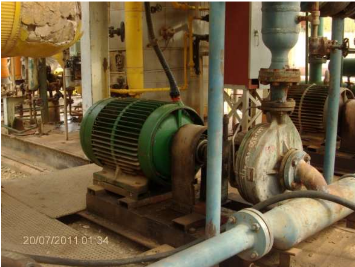
Figura 8. Bombas de condensado.
