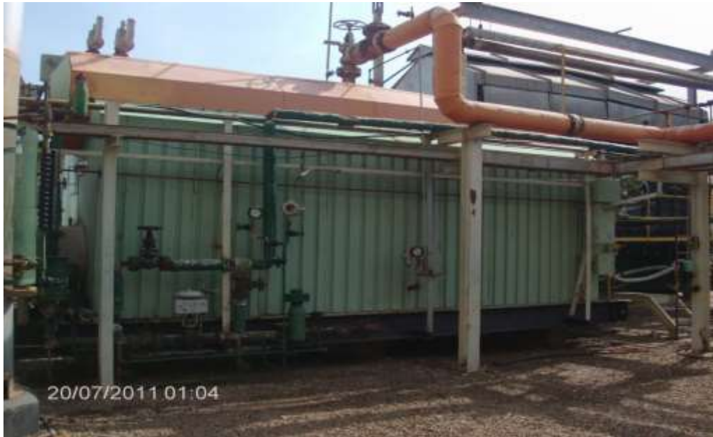
Imagen 16. Caldera de calor residual.
