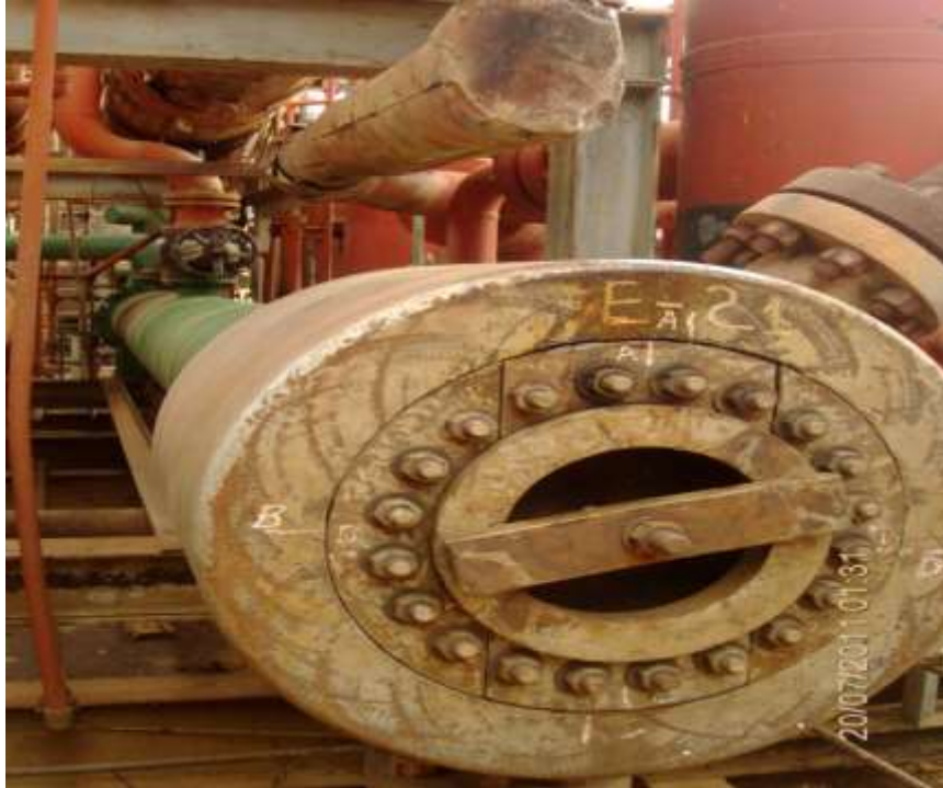
Imagen 23. Condensadores primarios de amoniaco.
