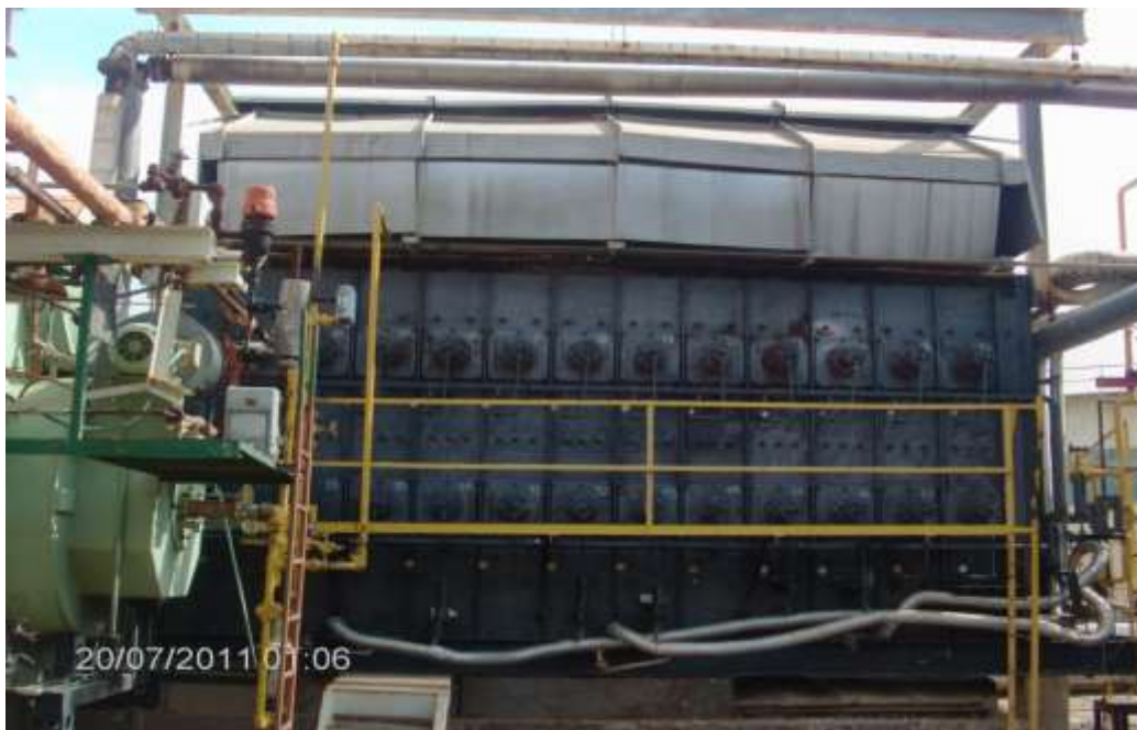
Imagen 17. Parte posterior de caldera de calor residual.
