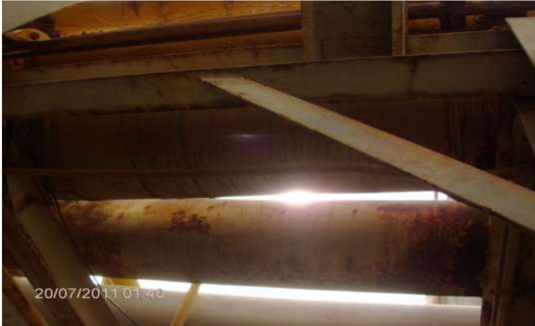
Imagen 9. Enfriador de gas de proceso.
