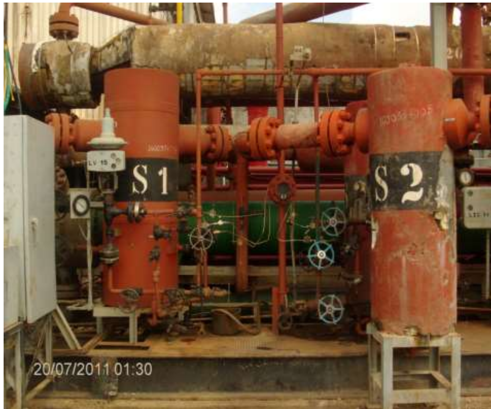
Imagen 26. Tanques de baja presión
