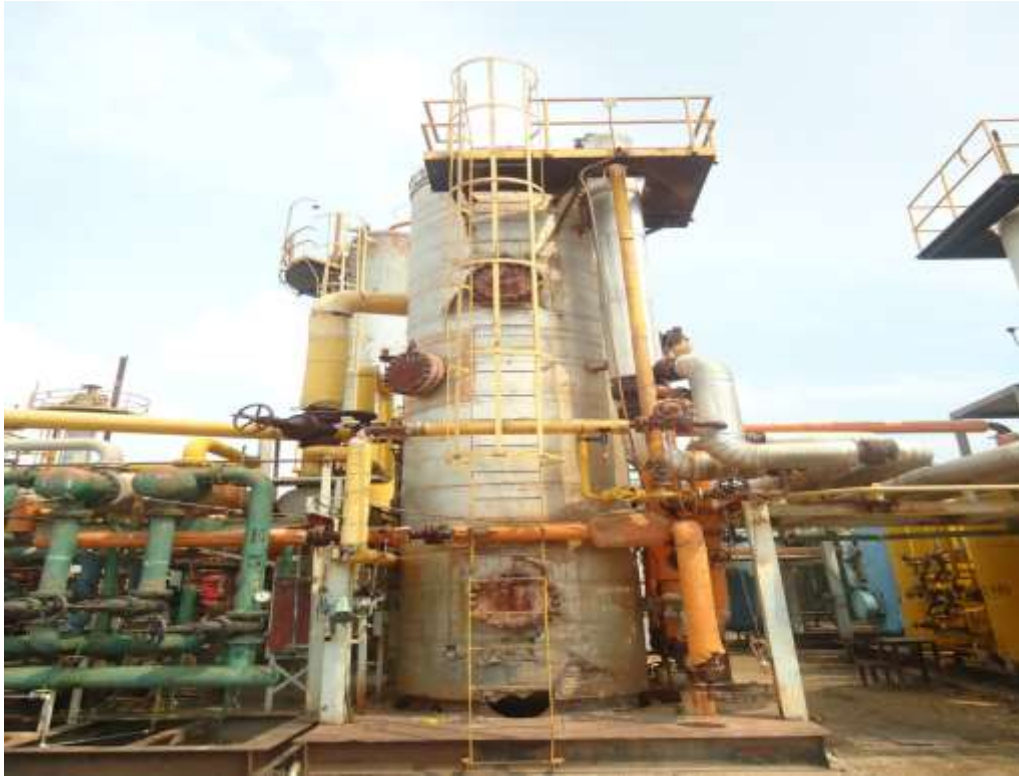
Figura 4. Reformador primario, H-1.
