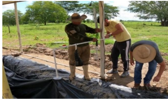
Ilustración 24 Acople de válvula de seguridad y sensores
