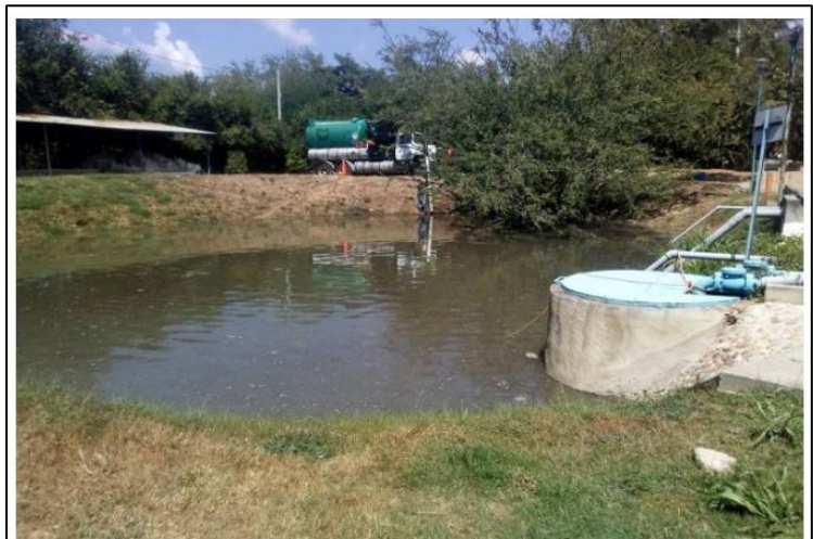
Desborde de aguas negras en Ptar de Nuevo Girón alarma a la comunidad (Foto: Suministrada / VANGUARDIA LIBERAL)
