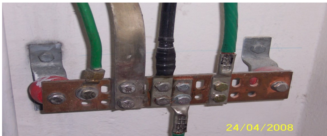
Figura 34. Barra principal de tierra para telecomunicaciones
