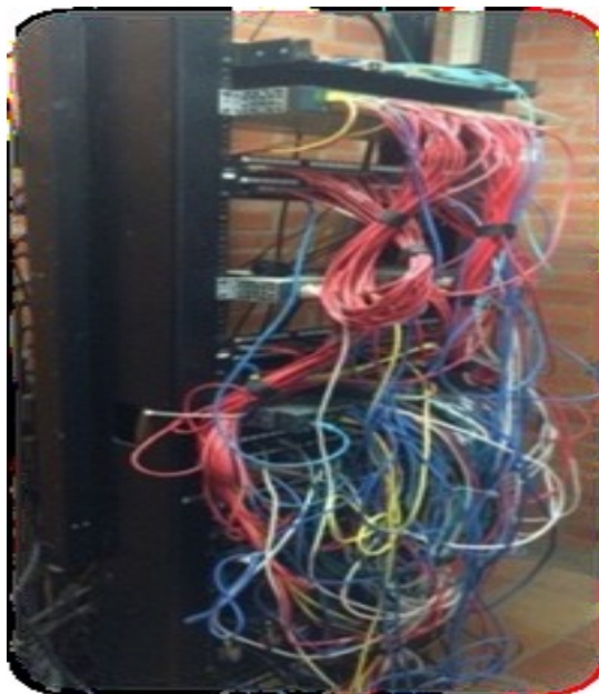
Figura 40. Bastidores de Distribución
