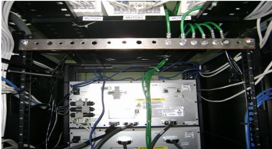
Figura 35. Barra de tierra para telecomunicaciones
