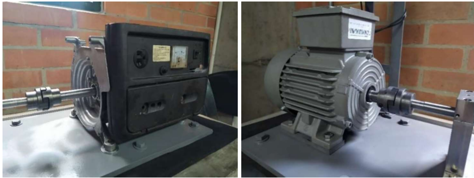
Figura 64. Generador y Motor.
