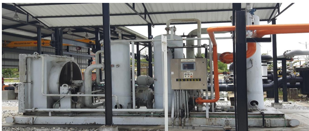
Figura 5. Unidad Recuperadora de Vapor Campo Moriche
