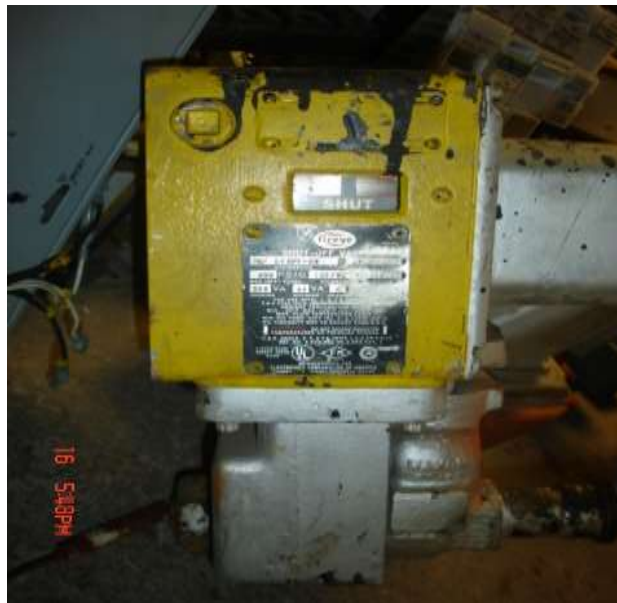
Figura 18. Válvula de shutdown de combustible, Refinería Barrancabermeja
