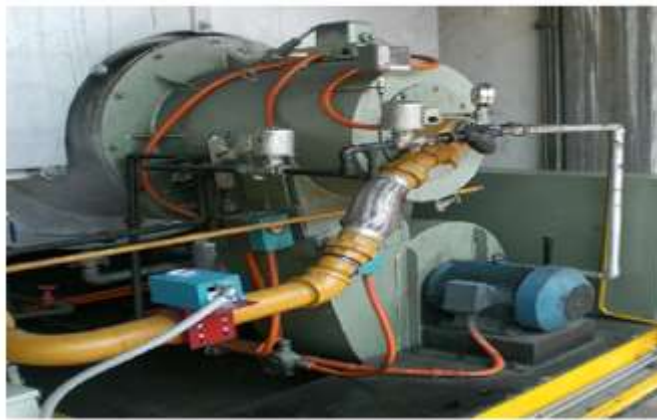
Figura 10. Caldera a gas.
