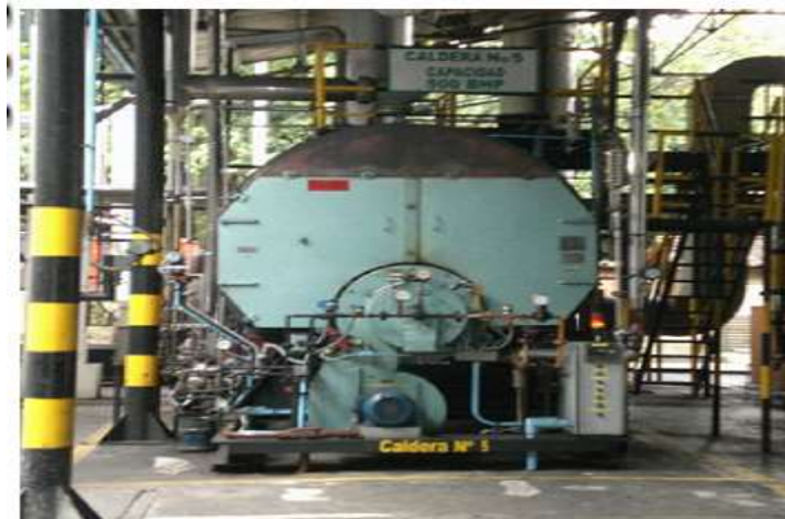
Figura 9. Caldera combustible líquido.
