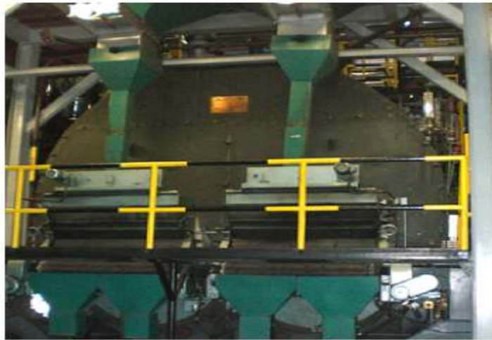
Figura 8. Caldera combustible sólido.
