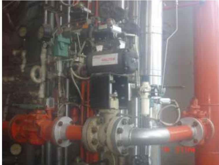
Figura 19. Sistema de control electrónico de quemadores, Refinería Barrancabermeja
